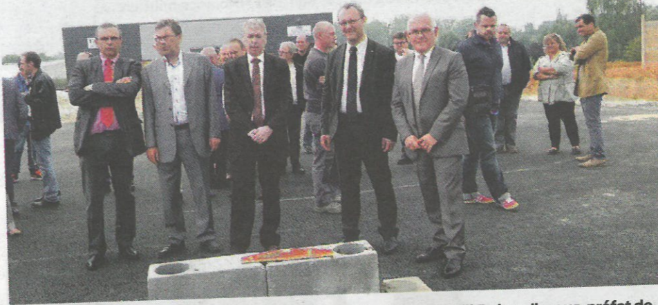
Philippe Cheval, président du Pays Santerre Haute-Somme, Joël Dubreuil, sous-préfet de l'arrondissement de Péronne, Grégory Labille, maire de Ham et Eric Legrand, président de la communauté de communes du Pays hamois ont posé la première pierre du futur bâtiment relais. Le chantier commence maintenant : il faut trouver des locataires.
